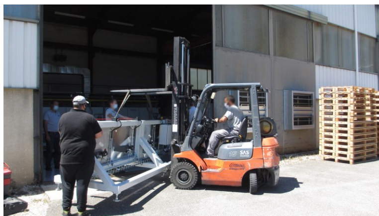
Installation de la machine CERA Engineering à l'atelier de St Didier de la Tour
